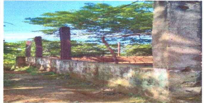
Foto 2: DETERIODO DE LA CIRCULACION DE MAYA DEL ESTABLECIMIENTO.
