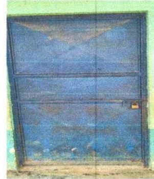
Foto 4: DETERIODO DE LAS PUERTAS DE LOS MODULOS
